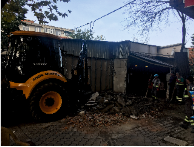
Resim 31. Kemaliye Mahallesi Metruk Bina Çalışması
